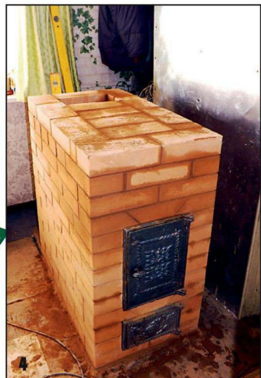
Топочная камера перекрыта.
